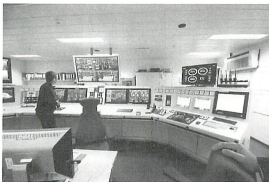
エンジンコントロール室
